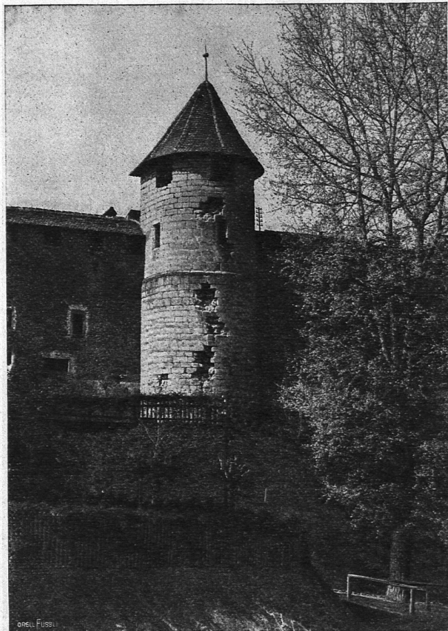
Murten: Zerschossener Turm.
