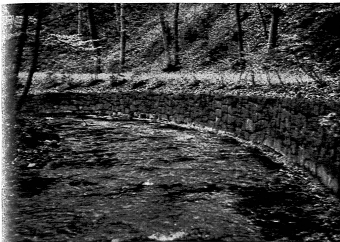
Abb. 10 Der gebändigte Wehrenbach. Meterdicke Betonmauer, in der Kurve wie mit dem Zirkel gezogen.
