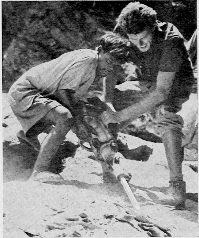
Strassen und Brücken sind Wege zum Fortschritt: im strassenlosen Nepal arbeiten Schweizer Tiefbautechniker am Bau von Brücken. Sie schaffen Verbindungen von Dorf zu Dorf.
