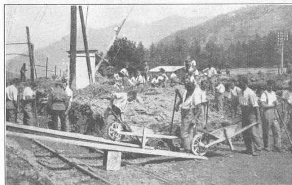
Lenk. — Freilegen der Bahn und der Strasse. La Lenk. — Dégagement de la voie et de la route.
