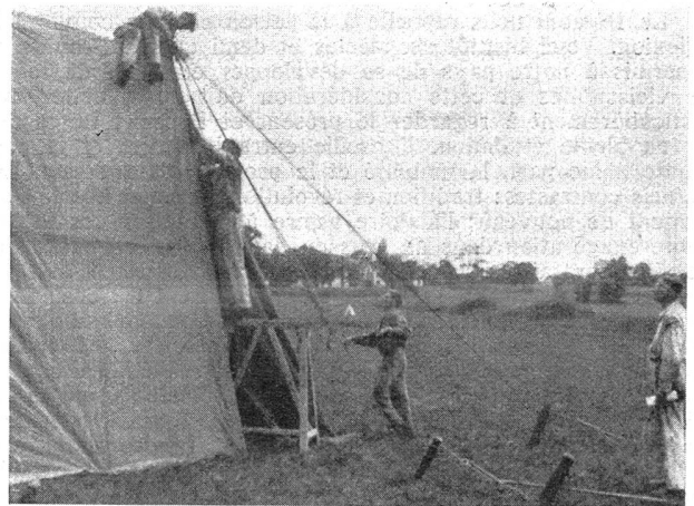
Zeltbau; Zuknöpfen des fertiggestellten Zelttes. — Montage d'une tente. Fermeture de la tente complètement terminée.
