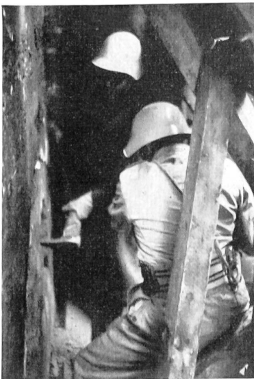
Das weitere Vordringen zu den Verschütteten wird durch eine Mauer behindert. In der Enge dieses schmalen Durchganges bemühen sich zwei Kameraden, die im Wechsel abgelöst werden, einen Mauerdurchbruch zu schlagen.
