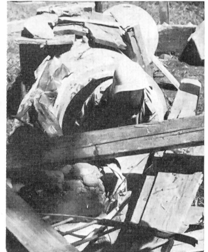
Sorgfältige Trümmerräumung über einem Verschütteten nach Ueberwindung der mit verschiedenen Trümmern versperrten Fuchsröhre.
