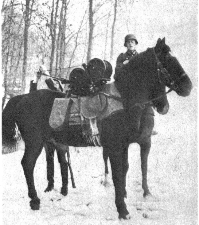
Für den Bau der Telefonleitungen wurden im verschneiten Gebirgs Gelände auch Pferde eingesetzt. Dadurch konnte der Linienbau rascher vorangetrieben werden. Die Kabelrollen sind auf dem Bastsattel des Tragtieres befestigt und werden im Marsch abgespult
