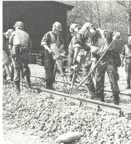
Ein neues Geleise wird eingebaut und geschottert. Ein moderner Gehörschutz gehört dazu. Diese Arbeit ist sehr lärmintensiv.
