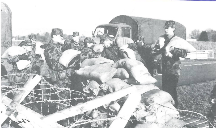
Angehörige der Füs Kp III/74 beim Stellungsbau auf dem Gelände des Flughafens Cointrin.
