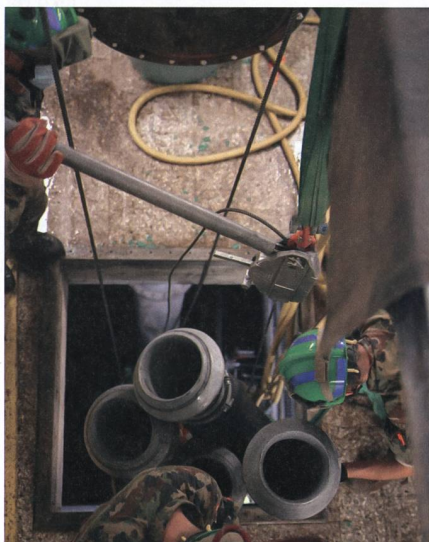
Durchdiener des Kata Hi Ber Bat beim Ausbau der Pumpen nach erfülltem Auftrag.
