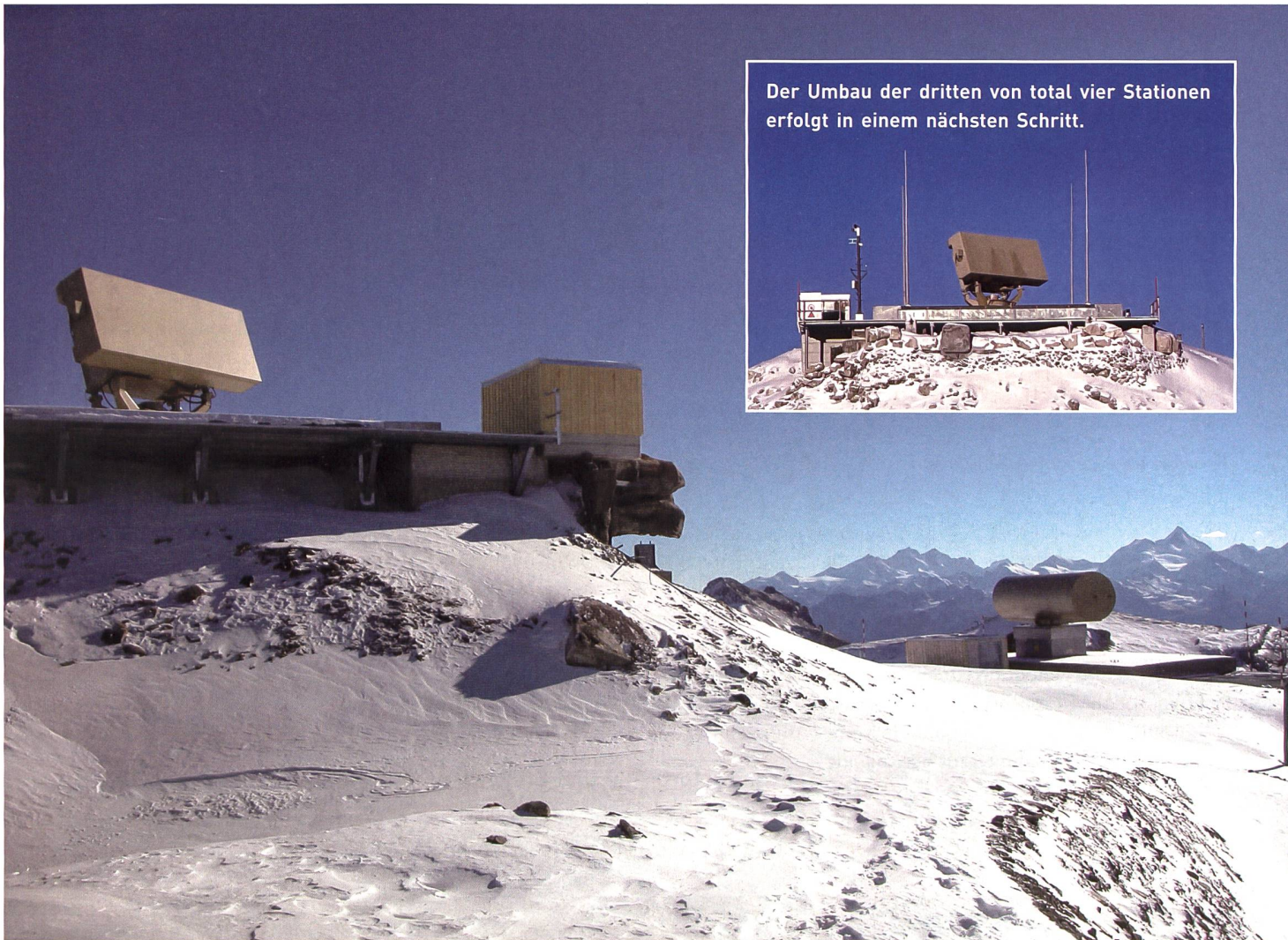
Die Umbauarbeiten fanden teilweise unter schwierigen Bedingungen auf bis zu 3000 Metern über Meer statt.
