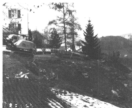
Bauvertüerung durch schwierige Baugrundverhältnisse.
