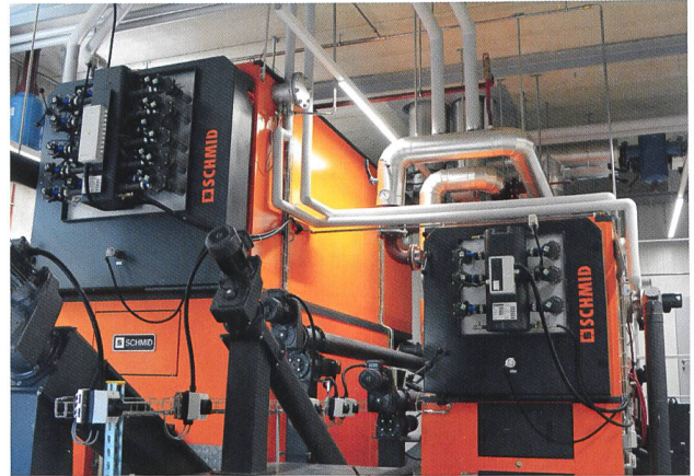
Die neue Holzschnitze-Kesselanlage: Die nächsten 25 Jahre soll hier durchgehend gefeuert werden.
