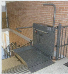
Plattformlift für Rollstuhlfahrer in der oberen Halteposition
