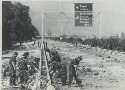
Intempéries: des unités de l'armée nettoient l'autoroute dans le canton d'Uri.
