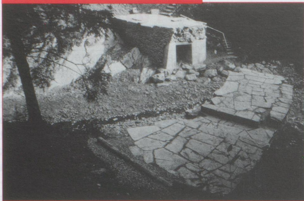
Restauration terminée, vue sur la culée droite, le béton soutient la partie subsistante en porte-à-faux (photo D. Ruchet). Beendigte Restaurierung mit Ansicht auf das rechte Widerlager, der Beton stützt den noch erhaltenen, auskragenden Teil (photo : D. Ruchet).
