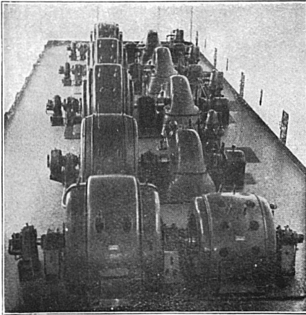
Maschinensaal d. Kraftwerkes Küblis d. A.-G. Bündner Kraftwerke, Leistung 47,000 PS
