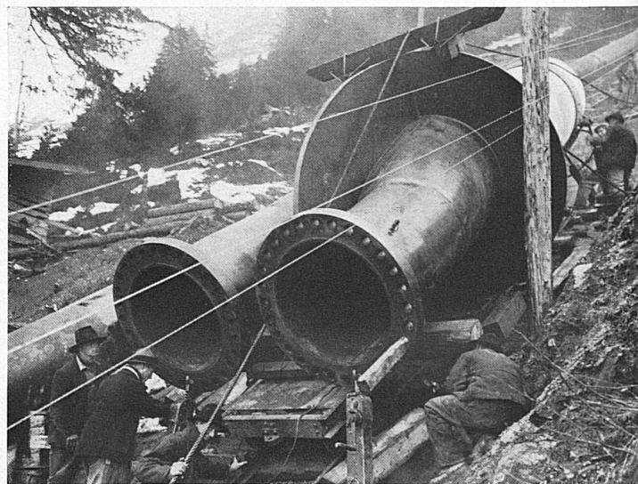
Ein interessantes Teilstück der Druckleitung: Das wichtige Hosenrohr für die Verzweigung des Druckschachtes in zwei freiliegende Rohrstränge. — Partie intéressante de la conduite forcée.
