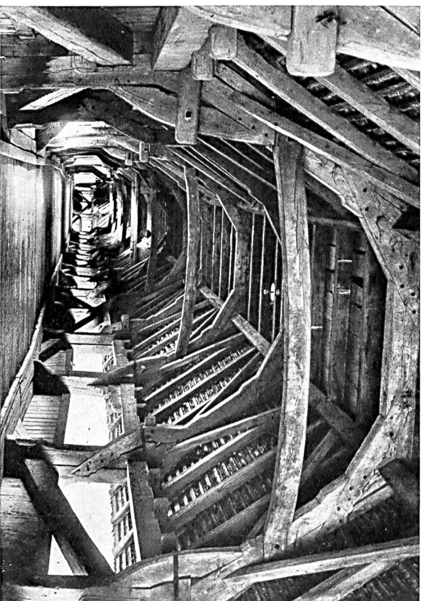
PONT EN BOIS SUR L'AAR, PRÈS DE BERNÉ, CONSTRUIT EN 1535 Vue de l'intérieur
