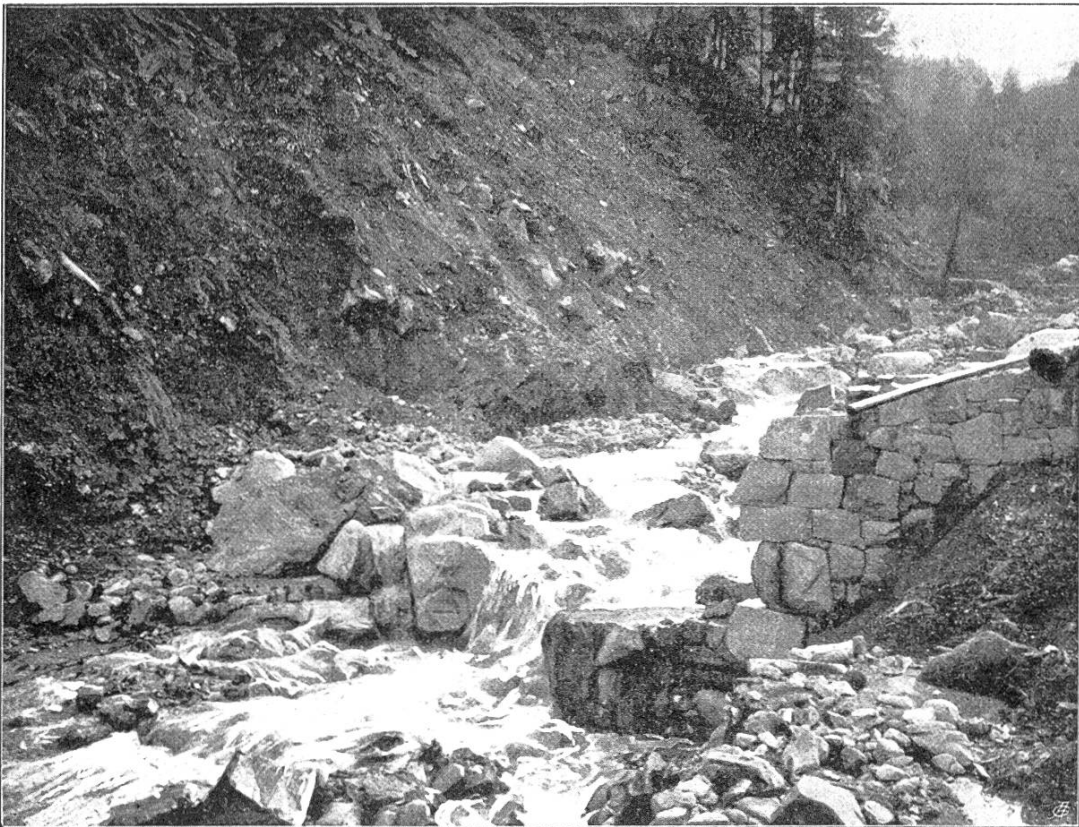
Zerstörte steinerne Sperrbauten an der Großen Schlieren bei Alpnach.
