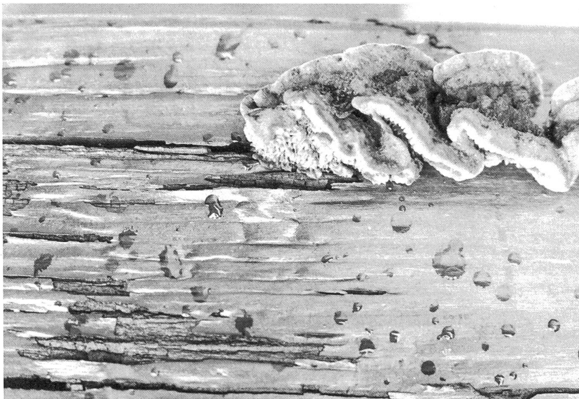
Abbildung 6. Durch Feuchtestau bedingter Pilzschaden ( Gloeophyllum ssp. ) an einem tragenden, bewitterten Holzbauteil.
