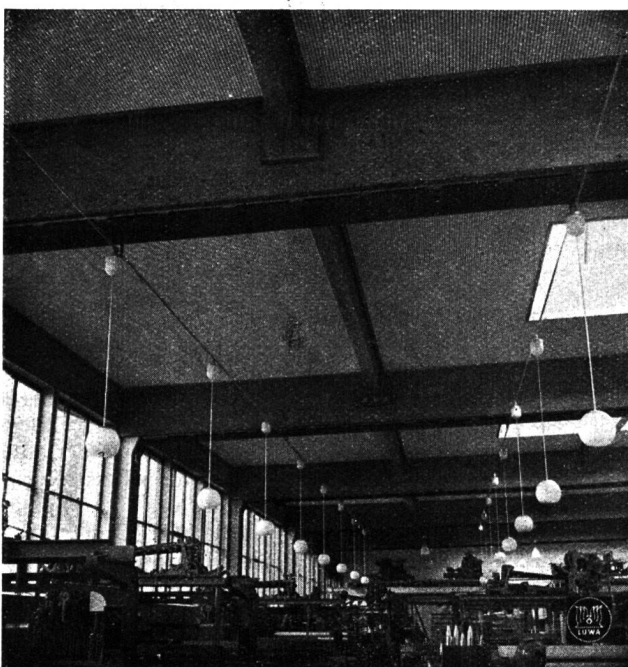
Abb. 2 Disposition der Zuluftverteilung von der Decke Photo: Emil Maurer, Zürich
