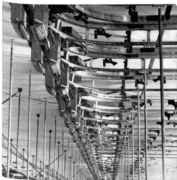
psb-Hängewarenlager, parallele Staustrecken von der Einlagerungsseite
