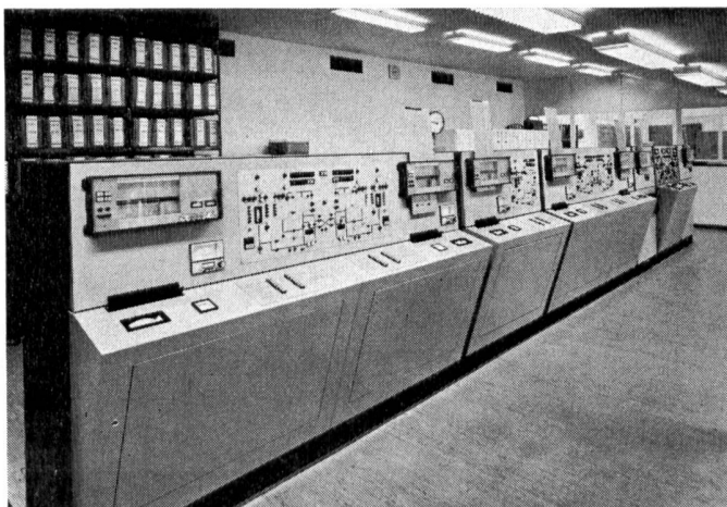
Automatenraum mit Steuergerät für die Färbeapparate
