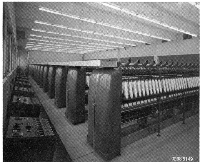
Abbildung 3 Heberlein-Falschzwirnmachines, klimatisiert durch Condifil-System: Zuluftkanal unter der Maschine, Abluftöffnungen unter der Decke.
