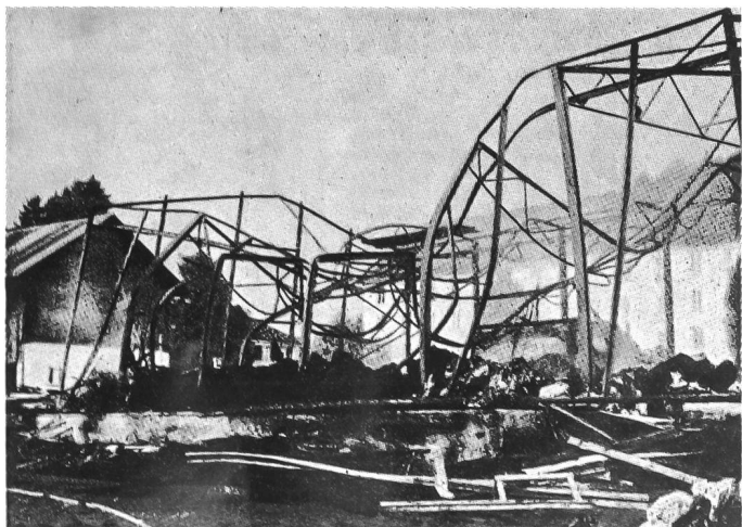
Totalschaden einer neuen Fabrikhalle in Stahlkonstruktion
