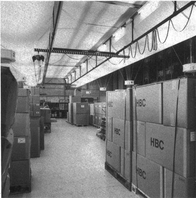
Im Grenzbereich zwischen Lager und Spedition ist richtig verstandener Brandschutz doppelt wichtig. Die Melder an der Decke sorgen für frühe Warnung, sobald Gefahr auftritt. (Foto Cerberus)
