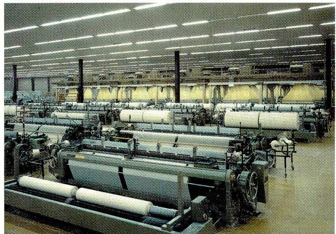
Foto 0286 0204-9 Websaal mit Sulzer-Rüti-Projektillwebmaschinen, ausgestattet mit der Condifil®-Arbeitszonenklimatisierung. Durch die Luftabsaugung im Deckenbereich kann trotz geringer Isolierung Kondensation von Luftfeuchte verhindert werden.
