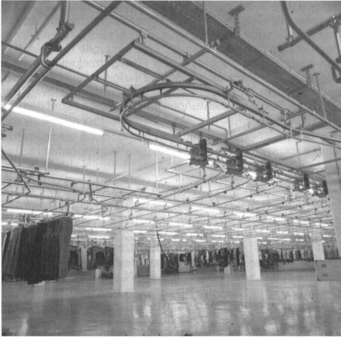
Über automatische Weichen gelangen die «Trolleys» aus dem Förder auf die Gefällslagerstrecken. Meiko Meier AG
