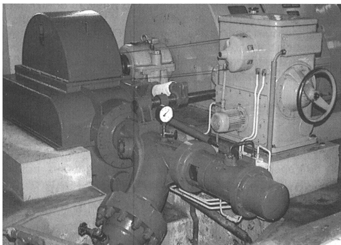
Brumbach-Werk, Pelton Turbine vorn und Generator im Hintergrund; die Leistung beträgt 1700 kWh
