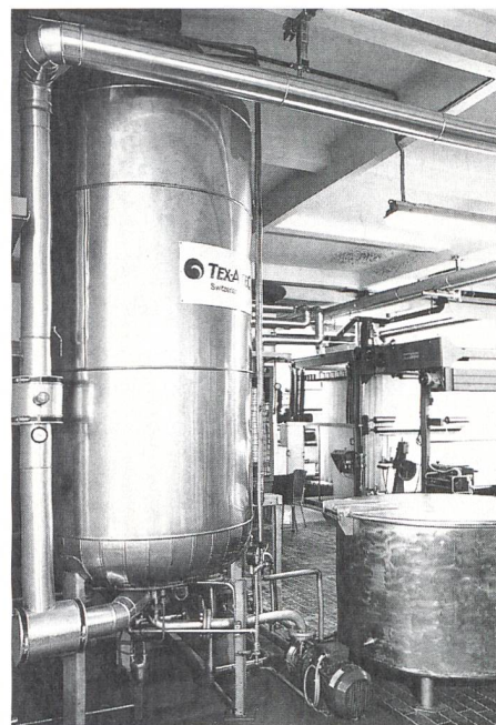
Der Oxidationsreaktor – Kernstück des neuen Konzeptes für die Abwasseraufbereitung
