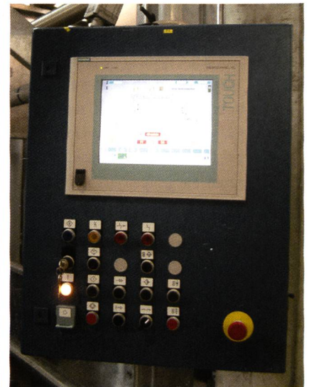
Die Steuerung der Anlage
