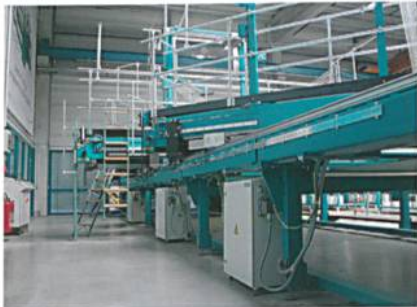
Abb. 3: Segmentierung des Schusseintragsgestells und der Schusslegersysteme mit je einem Schaltschrank
