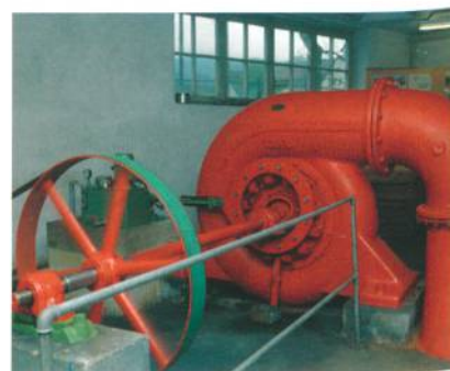
Abb. 2: Die Turbine aus dem Jahre 1862 wird vom Wasser der Luterer angetrieben und produziert heute jährlich rund 80'000 Kilowattstunden elektrische Energie
