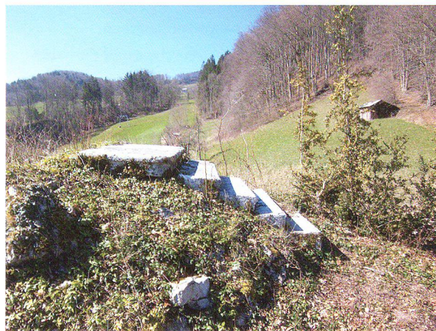
Abb. 5: Flühli, ehemaliges Kabinett, Stufen und Podest aus gehauenen Kalkstein. Ausblick gegen Südwesten. April 2007.
