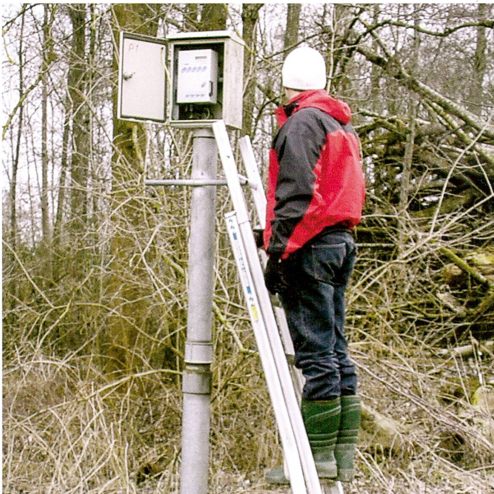
Abbildung 7: Hohes Überstandrohr mit installierter automatischer Aufzeichnung.
