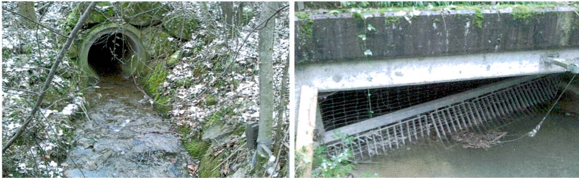
Abbildung 8: Die enge Röhre eines Gewässerdurchlasses wurde im Untersuchungszeitraum nicht von Wildtieren zur Querung der A7 benutzt (links). Die vorhandene Bibersperre eines Gewässerdurchlasses (rechts) verunmöglichte Wildtieren die Querung.
