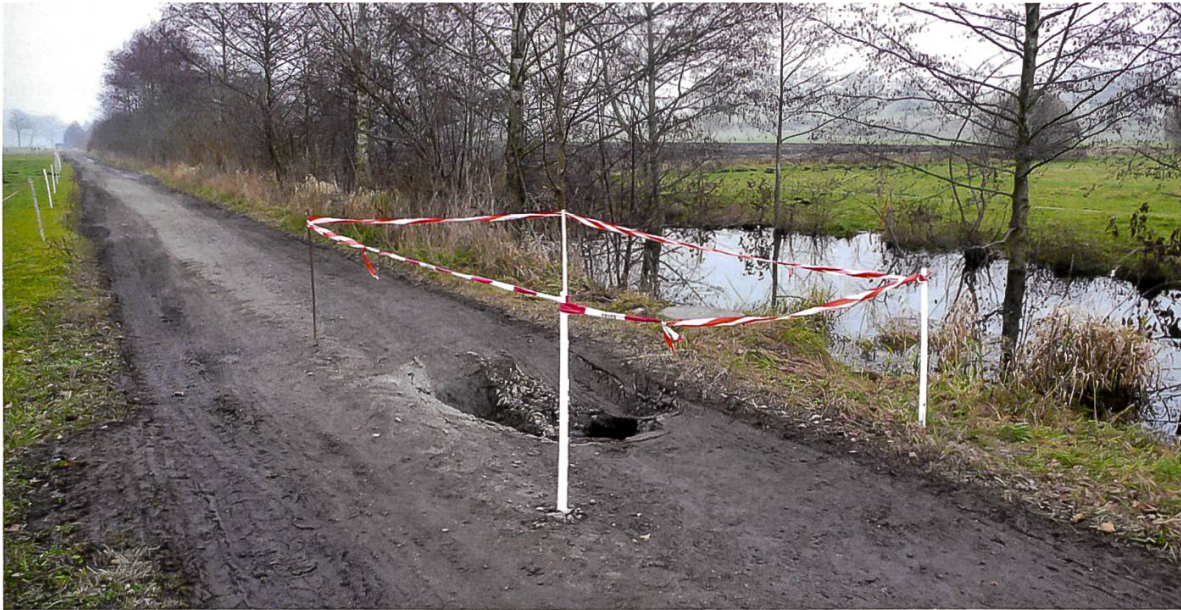
Abbildung 3: Biber graben ihre Erdbaue immer vom Wasser her in die Uferböschung und legen den Wohnkessel direkt unter der Böschungskante an. Liegen hier Wege, können diese unter der Last von Fahrzeugen einstürzen. Foto: Christof Angst.
