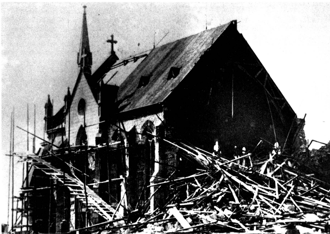
Abb. 16 Für Schlagzeilen in der Schweizer Presse sorgte der Turmeinsturz vom 21. Juli 1893 der im Bau begriffenen katholischen Kirche Bazenhaid. Schlechte Mauerung und zu hohe Druckbewegungen brachten den Frontturm und Teile des Kirchenschiffes zum Einsturz. Beim Wiederaufbau begnügte man sich mit einem etwas niedrigeren
