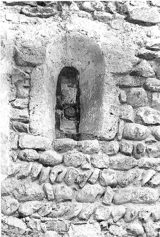
St. Verena in Magdenau. Romanisches Mauerwerk und Fensterchen in der Nordmauer des Schiffs nach Freilegung 1968. – Foto Walter Fietz, St. Gallen.
