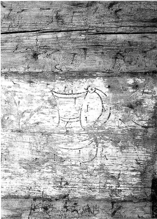
In der rückseitigen Strickwand Spolie einer Wandmalerei, darstellend einen Zinnkrug, um 1600 (wieder zugedeckt). – Foto B. Anderes, Rapperswil.
