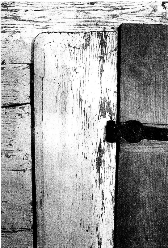
Pfosten der Türe vom Gang zum rückwärtigen Schopf. An der gerundeten Ecke Fase mit subtilem Blättchen. Auf der Gegenseite (im Schopf) Eselsrücken. Alte Türe mit Gratleiste und Langband sowie – unter weisser Tünche – ein sauberer graublauer Anstrich auf dem Türpfosten.
