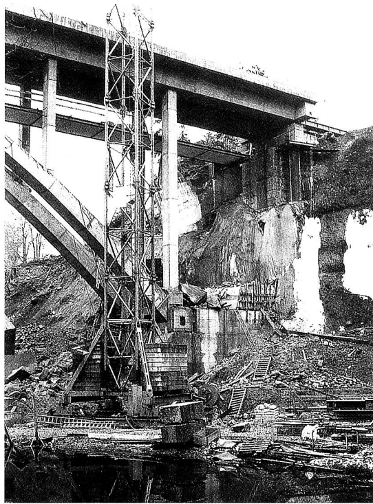
Ein Blick auf die Problembereiche nach der Sprengung: Das ausgebrochene Widerlager ist ebenso erkennbar wie die zugehörigen Trümmer im Kämpferbereich der neuen Bogenbrücke.
