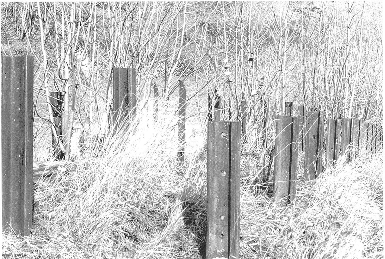
Die Sperre zog sich weit hangaufwärts. Aufnahme Mai 1999.
