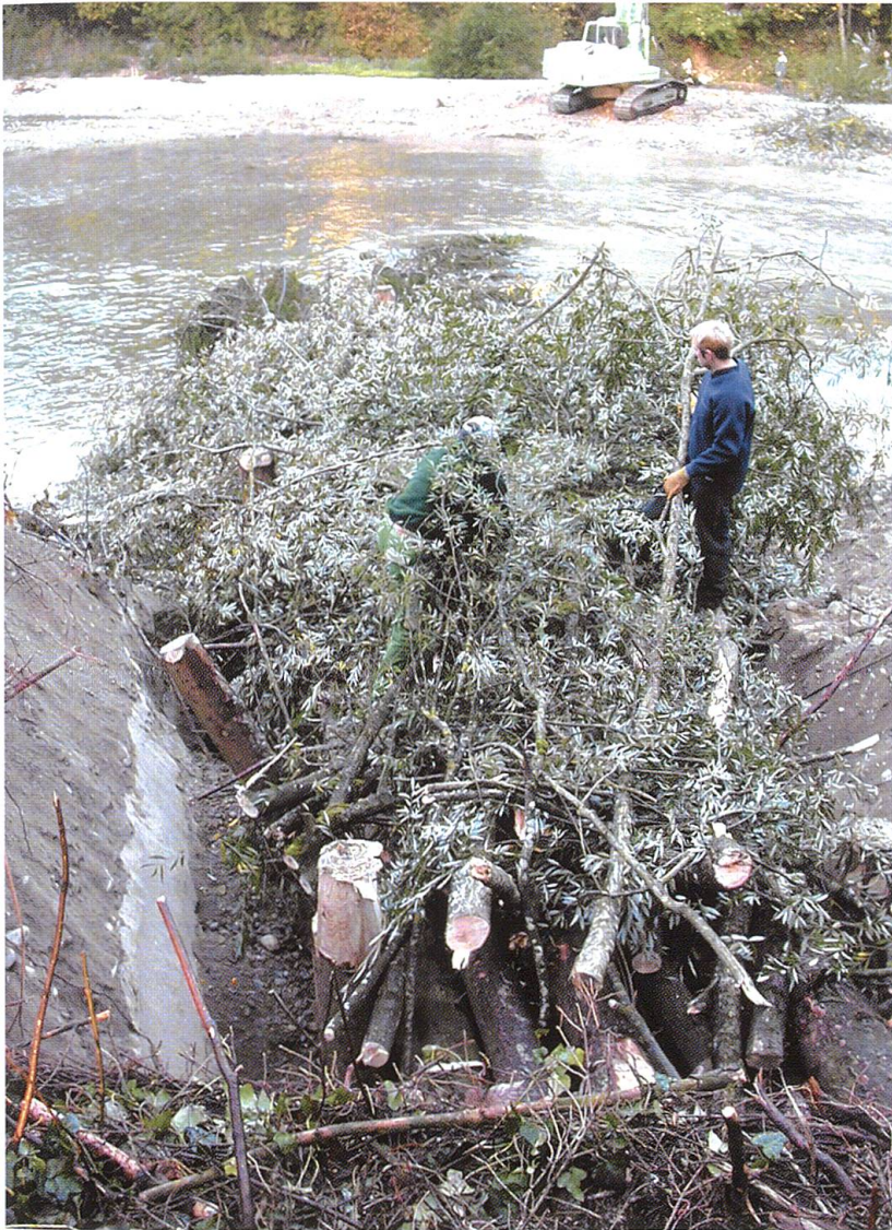
Bau einer Baumbühne als Uferschutz an der Interventionslinie Seite Niederstetten. Über das Baumbündel werden Weidenäste gelegt und in der Böschung mit Erdmaterial überdeckt, Oktober 2005 (Abb. 16).
