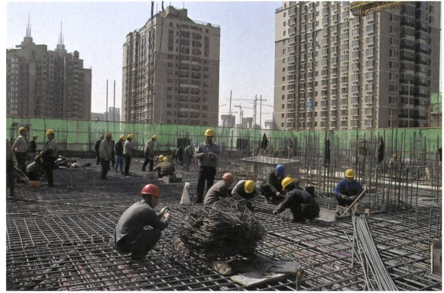
Architekt: Baumschlager & Eberle, Technologie: Keller Technologies AG, Baustelle der POPMOMA-Apartments, Beijing, Zustand Juli 2006, Foto von CC ETHZ.
