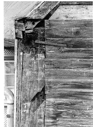
Abb. 13 Menzingen, Restaurant Ochsen, Neudorfstrasse 11. Blick Richtung Westen auf die Südostecke des Altbaues, 1. Obergeschoss. Nach Abnahme der letzten Verkleidungen werden der originale Übergang von der Dachkonstruktion zum Eckständer, aber auch verschiedenste nachträgliche Änderungen sichtbar, wie die Ausfachungen rechts; Zustand vor dem Abbruch Februar 1992.
