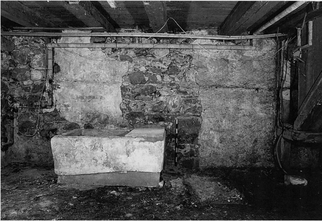
Abb. 12 Cham, Haus Obermühle, Untergeschoss. Blick auf die Südhälfte der Westwand, innen, nach teilweiser Putzentfernung. Sichtbar wird das ältere Mauerwerk sowie eine vor die Wand gestellte Wanne, deren Zweck und Zeitstellung nicht sicher zu bestimmen sind; Zustand 1992.
