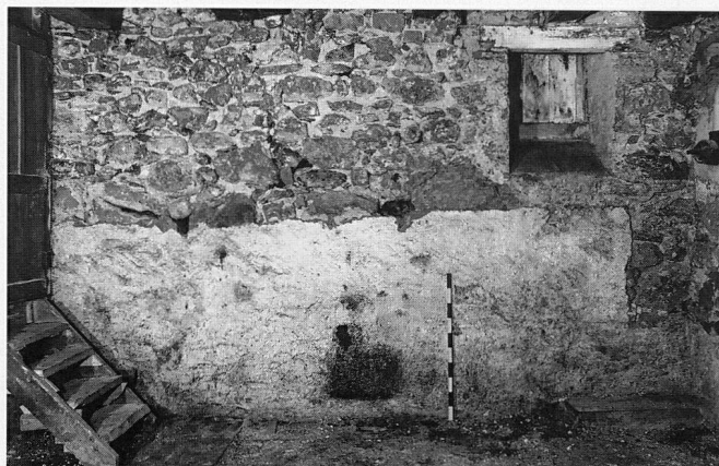
Abb. 11 Cham, Haus Obermühle, Untergeschoss. Blick auf die Nordhälfte der Westwand, innen, nach teilweiser Putzentfernung. Sichtbar wird das ältere Mauerwerk sowie (oben rechts) ein nachträglich eingebrochenes Fenster; Zustand 1992.
