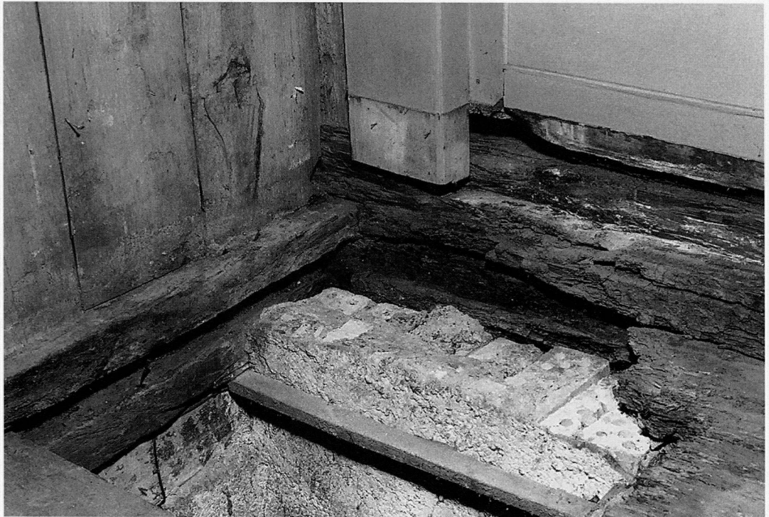
Abb. 15 Cham, Haus Obermühle, Erdgeschoss, Südost-Raum (gute Stube) innen, während der Untersuchung 1990. Blick Richtung Nordosten: Rechts die originale Schwelle der Ostfassade, links die eingezapfte Schwelle der südlichen Flurwand; Holz gefällt Herbst/Winter 1591/1592.
