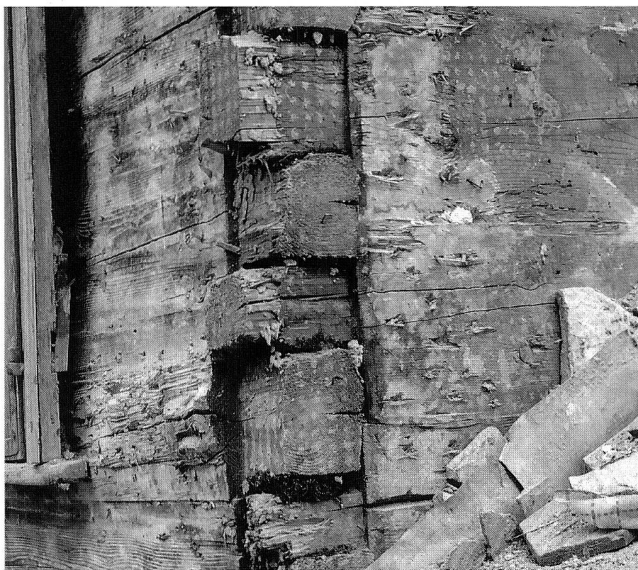
Abb. 12 Zug, St.-Oswalds-Gasse 16/18. Haus Nr. 16, Blick Richtung Südwesten auf die Nordostecke des Blockbaues. Nachträglich abgesägte Balkenvorstösse im 2. Obergeschoss.
