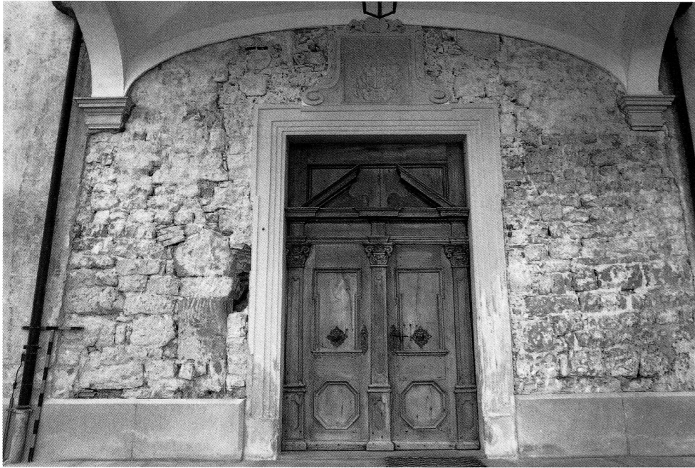
Abb. 12 Die 1997 freigelegten Befunde im Bereich des Vorzeichens an der Kirchenwestseite (vgl. Abb. 13). Einteilung der Messlatten in 10 cm.
